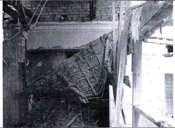
Foto 10. Daño severo y colapso del cielo raso.
