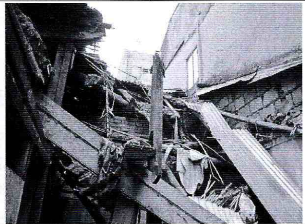
Foto 12. Colapso de la cubierta.
