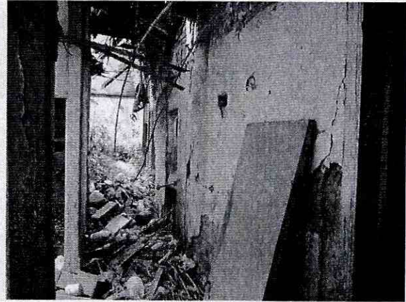
Foto 4. Muros internos, deterioro, agrietamientos y fracturas.
