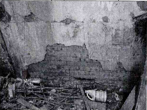
Foto 8. Desprendimientos, grietas y fracturas en muro.
