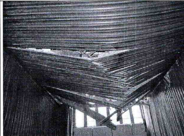
Foto 11. Daño del cielo raso del sector frontal.
