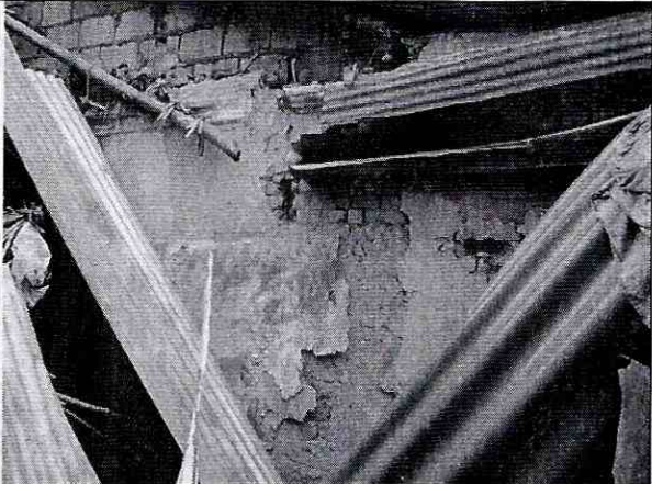
Foto 7. Deterioro generalizado de los muros internos.
