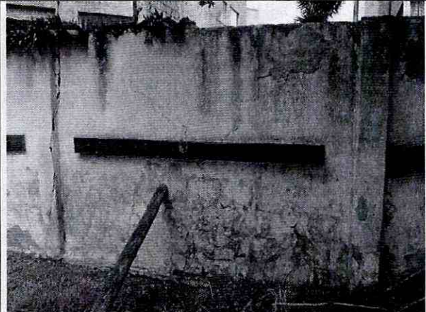
Foto 4. Fisuras y agrietamientos en el muro.
