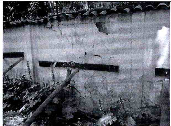
Foto 10. Muro de lindero costado norte, deterioro general.
