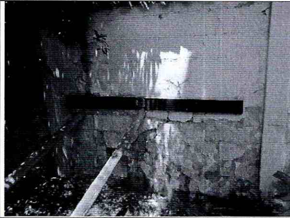
Foto 9. Fractura del muro, daño severo del muro.
