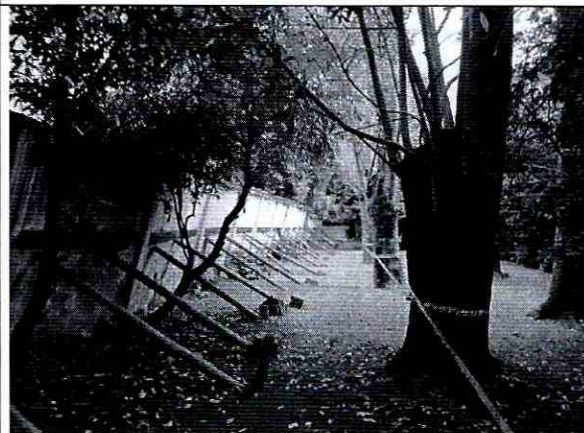
Foto 13. Pérdida de verticalidad con caída al interior.
