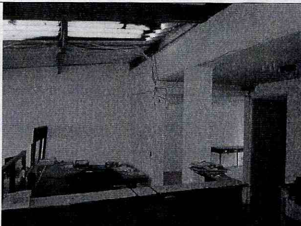
Foto 5. Segundo piso, agrietamiento de muros.
