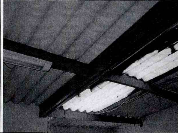
Foto 25. Cubierta con deformaciones y falla funcional.
