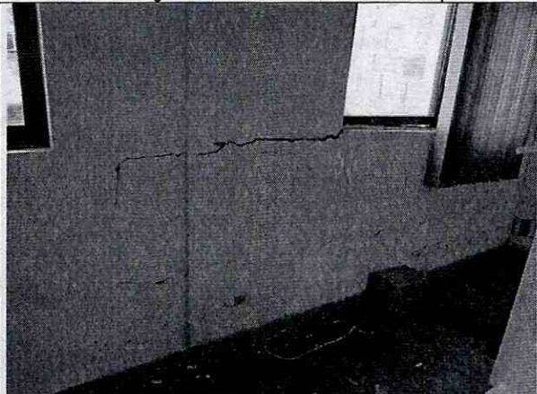
Foto 16. Agrietamiento y fracturas, daño severo de muros.
