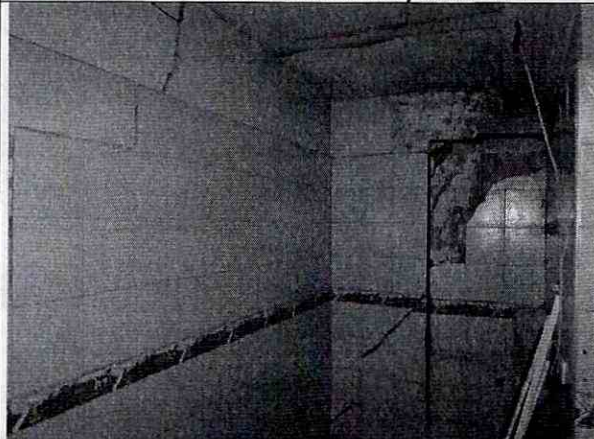
Foto 27. Grietas y fracturas en muros, sector posterior.
