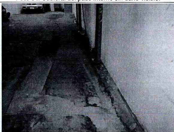
Foto 36. Hundimiento del piso en el costado sur.
