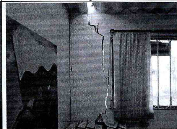
Foto 12. Fractura con varios centímetros de separación.
