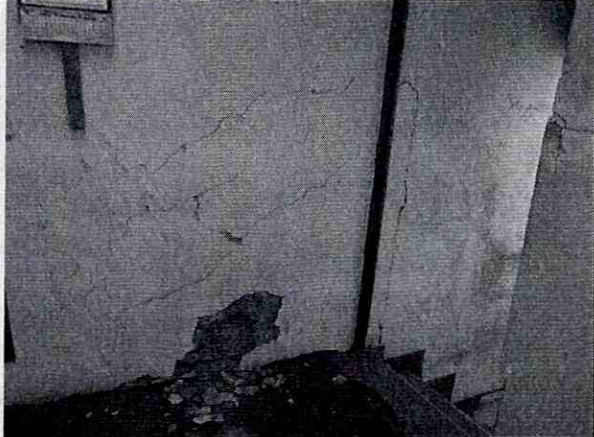
Foto 29. Grietas en muros de segundo piso, sector posterior.
