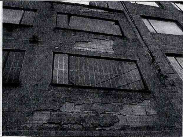
Foto 2. Fachada con grietas y desprendimiento de acabados.
