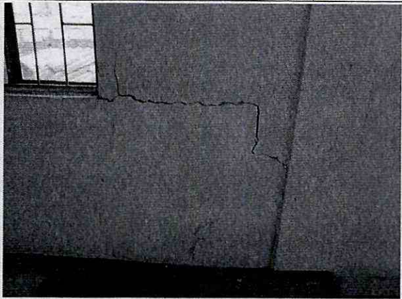
Foto 30. Fractura de muros de segundo piso, sector posterior.
