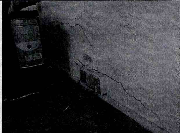
Foto 14. Agrietamientos en muros de tercer piso.
