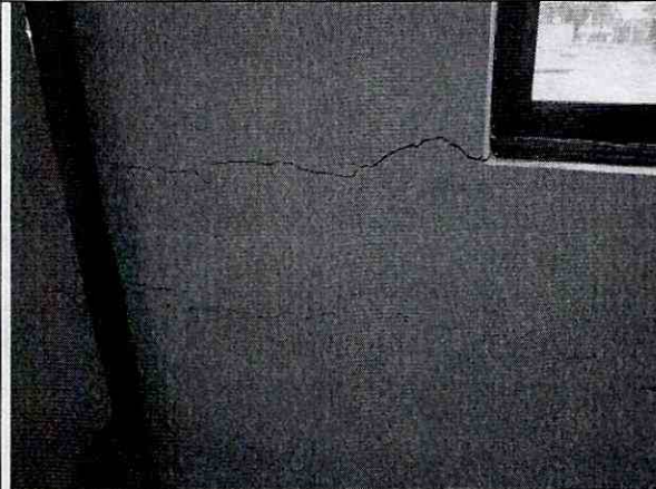
Foto 17. Grietas en muros de tercer piso.
