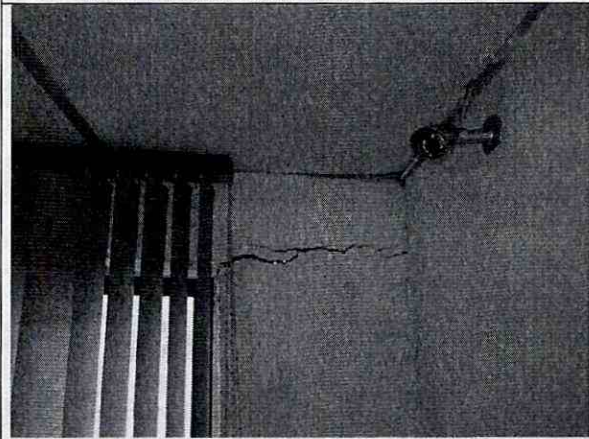
Foto 15. Fractura en muro de tercer piso.
