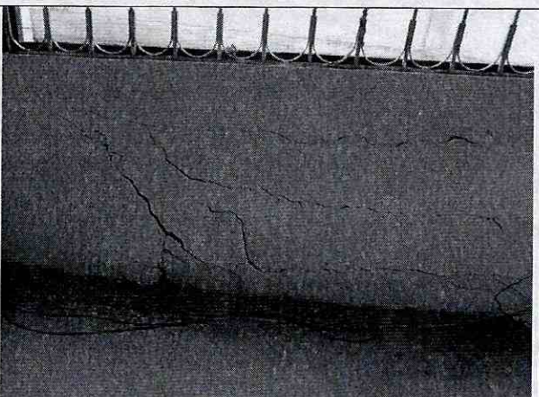
Foto 6. Grietas en antepecho, sector frontal.
