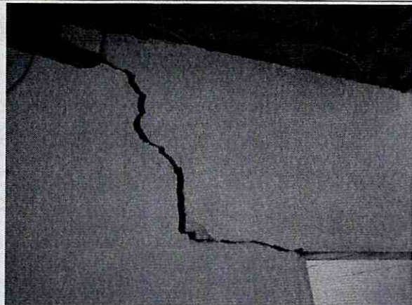
Foto 28. Daño severo de muros del sector posterior.
