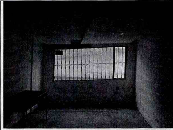
Foto 13. Deformación de vanos de ventanas.
