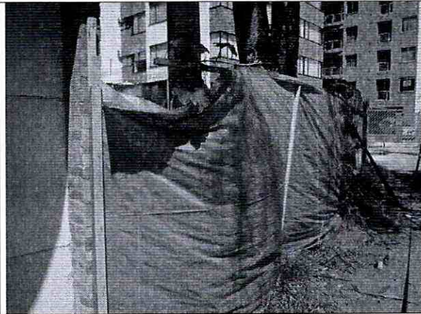
Foto 7. Fallo parcial, lona sintética provisional.
