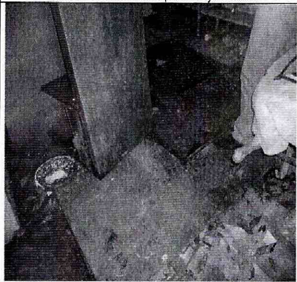
Foto 15. Deterioro de los acabados de la placa de piso.
