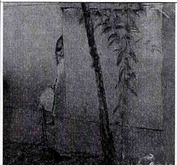
Foto 6. Fractura en la parte inferior del muro.
