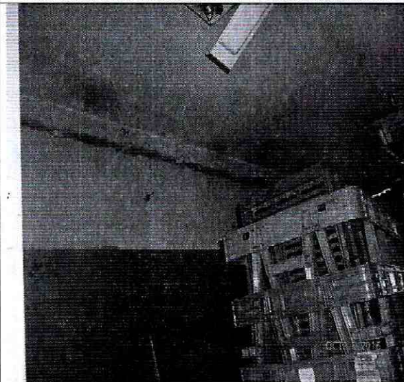
Foto 11. Fractura horizontal en la parte superior del muro.
