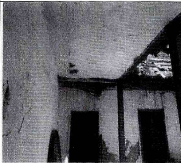
Foto 6. Detalle del entrepiso con colapsos parciales.
