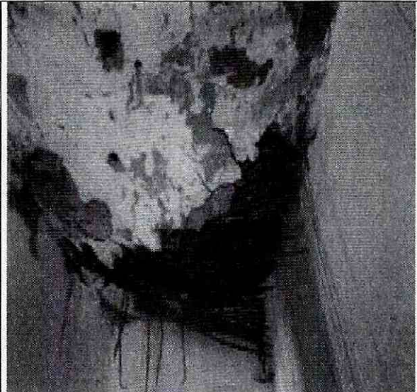
Foto 4. Primer piso. Detalle del cielo raso donde se observa colapso de loseta inferior.
