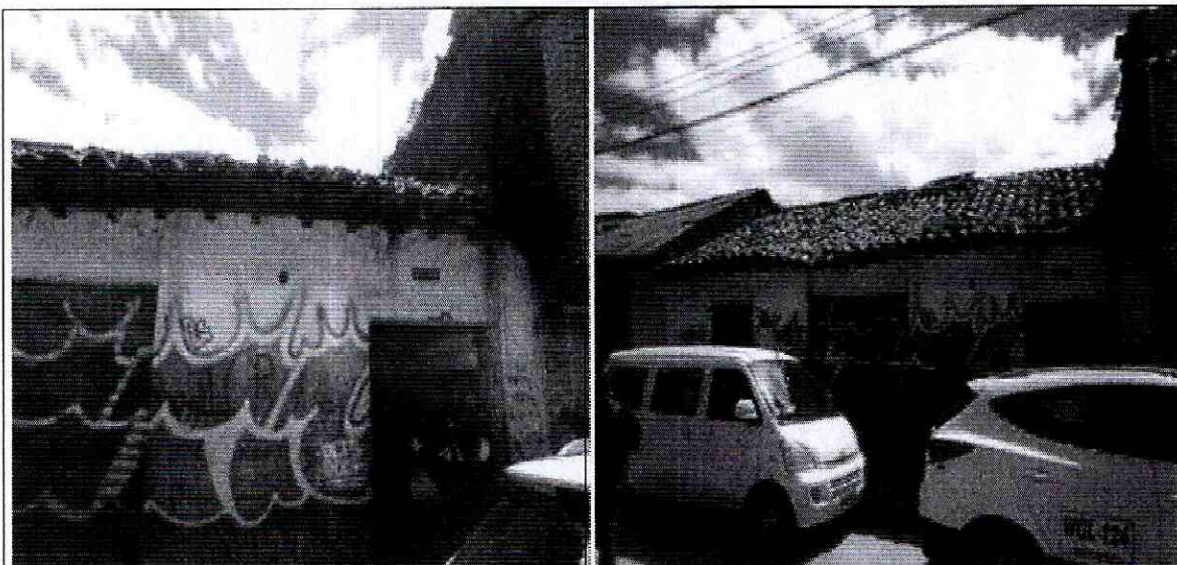
Fotos 1 y 2. Fachada inmueble. Evidentes daños importantes en fachada.
