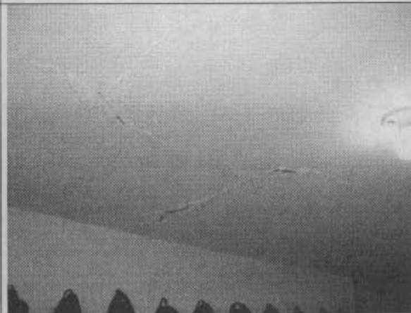
Foto 10. Placa con marcas de infiltración de agua.
