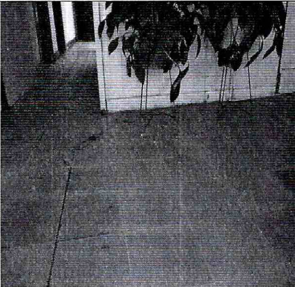
Foto 33. Grieta y deformación en el piso.
