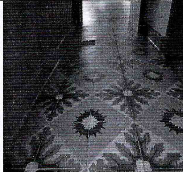
Foto 34. Hundimientos puntuales del piso.
