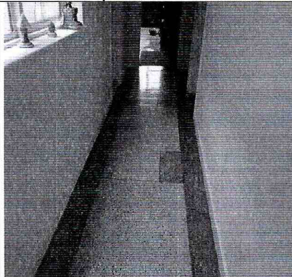
Foto 21. Entrepiso con inclinación hacia el costado norte.
