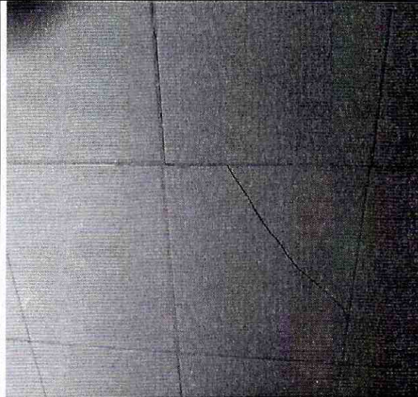
Foto 15. Grieta en muro del baño del segundo piso.
