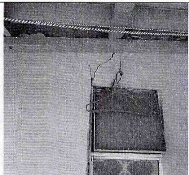
Foto 18. Grieta en muro del tercer nivel.
