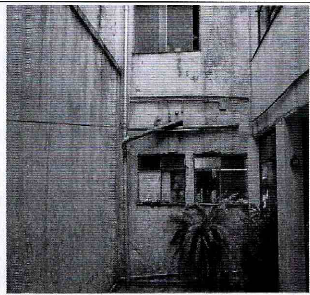
Foto 8. Muros de patio interno, deterioro de acabados.
