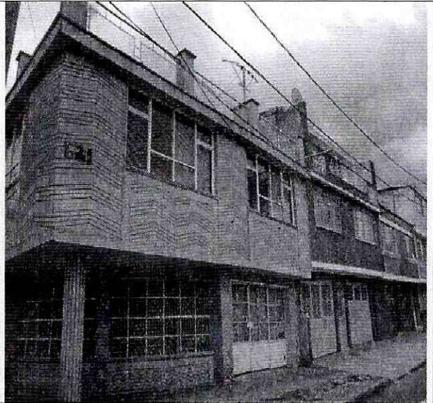
Foto 2. Estado de fachada en el costado oriental.
