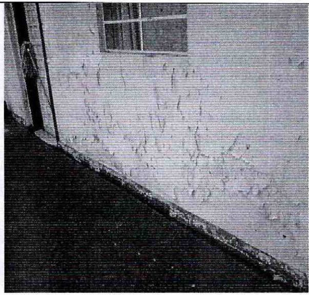
Foto 20. Deterioro de los acabados de los muros.
