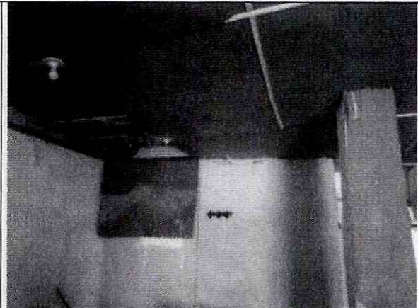
Foto 4. Primer piso. Detalle del cielo raso donde se observan daños moderados.
