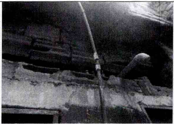
Foto 5. Detalle de muros incompletos modificados artesanalmente con riesgo de desprendimientos.
