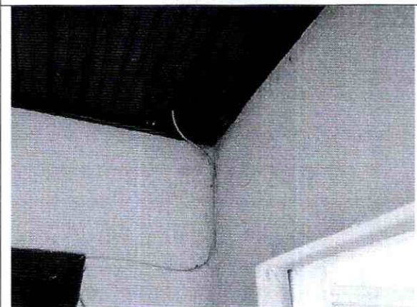
Foto 33. Daño moderado del cielo raso en madera.
