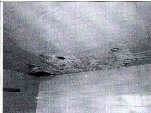
Foto 35. Desprendimiento del acabado del cielo raso.
