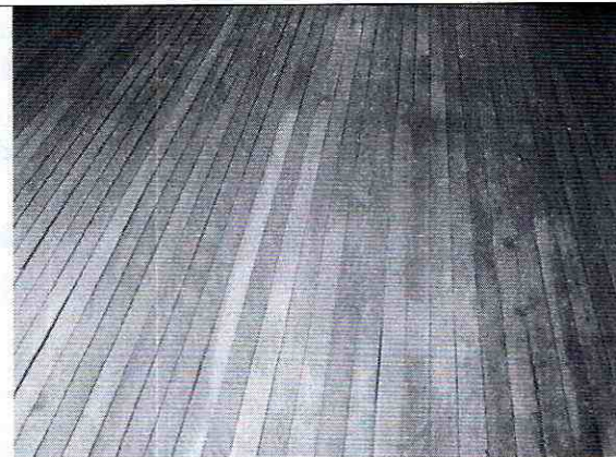
Foto 24. Deterioro leve de listones de madera del entrepiso
