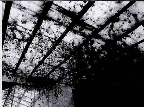
Foto 38. Marquesina del patio, falta de mantenimiento.
