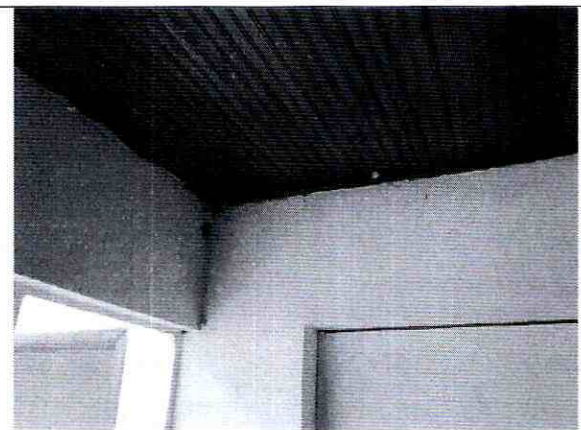
Foto 34. Filtración de agua, fallo funcional de cubierta
