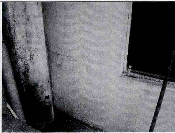
Foto 16. Grieta en muro de la edificación posterior.
