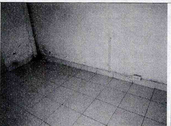
Foto 6. Deterioro de los acabados de muros por humedad.
