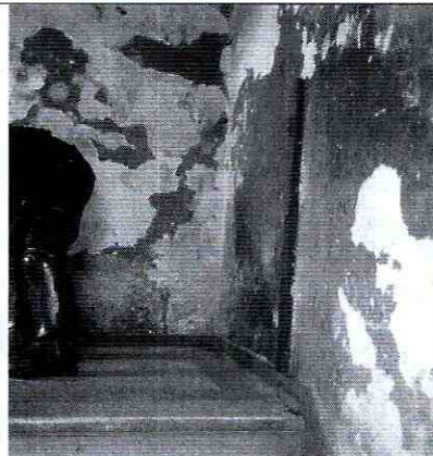
Foto 22. Muros del punto fijo con deterioro moderado
