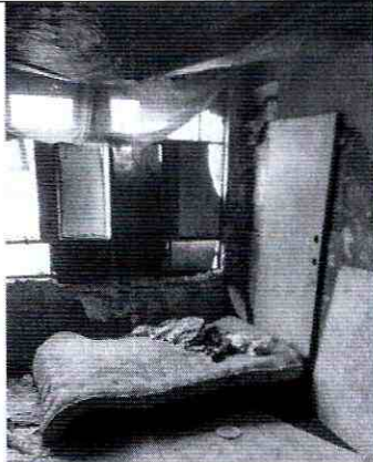
Foto 7. Daño leve en muros por falta de mantenimiento
