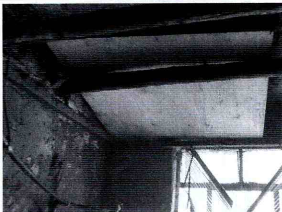
Foto 11. Elementos de cielo raso con pérdida de apoyo.
