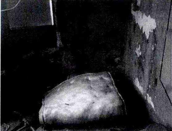
Foto 15. Presencia de humedad en muros del tercer nivel
