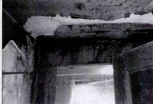
Foto 16. Deterioro generalizado en el entrepiso de madera
