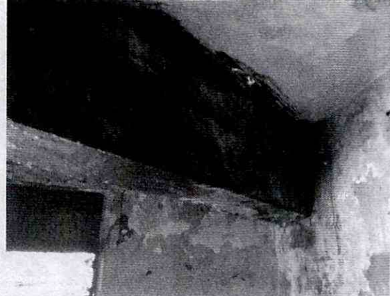
Foto 14. Elementos de vigas y columnas con presencia de humedad excesiva
