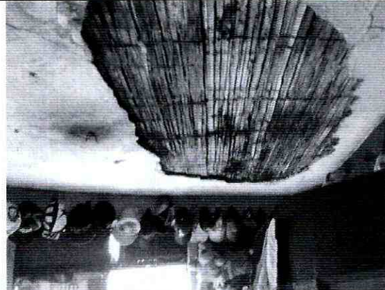
Foto 10. Desprendimiento del revoque del cielo raso
