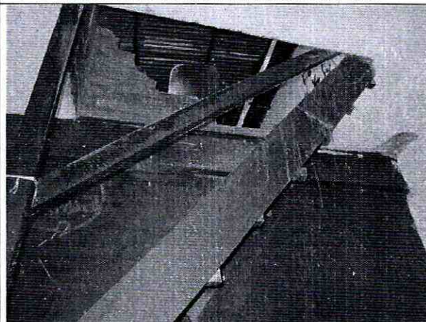
Foto 23. Escaleras del sector de los locales, daño leve.
