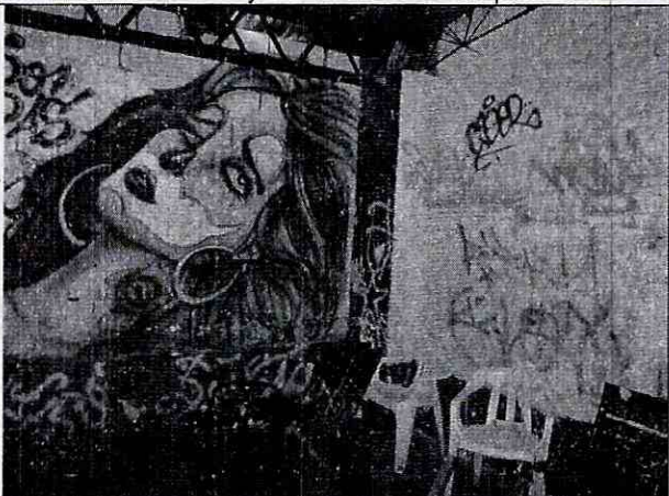
Foto 17. Muros en el sector del mezzanine daño leve.
