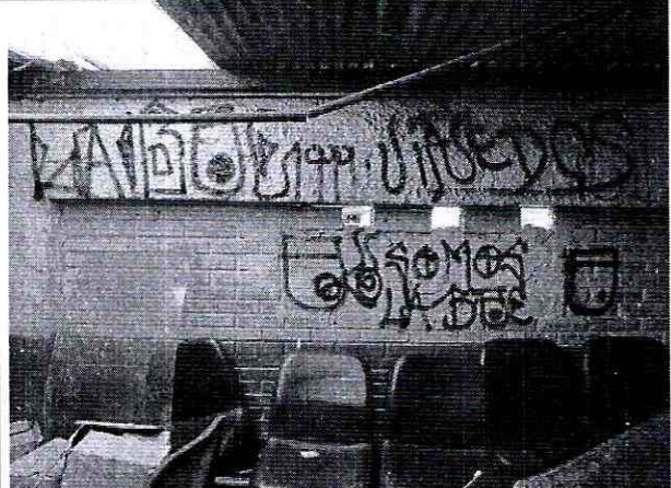
Foto 8. Daño leve de muros de segundo piso.
