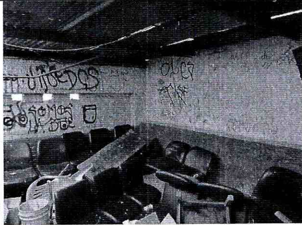
Foto 7. Muros en segundo piso con deterioro, daño leve.
