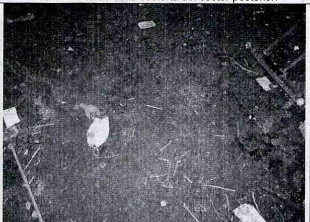
Foto 30. Deterioro de la placa de piso del sector posterior.
