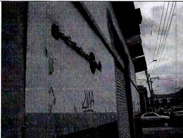
Foto 15. Pérdida de verticalidad, amarre provisional.
