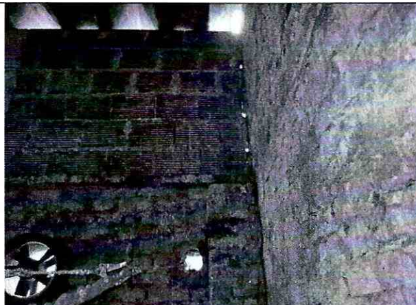
Foto 8. Muro suelto sin traba con el perpendicular.
