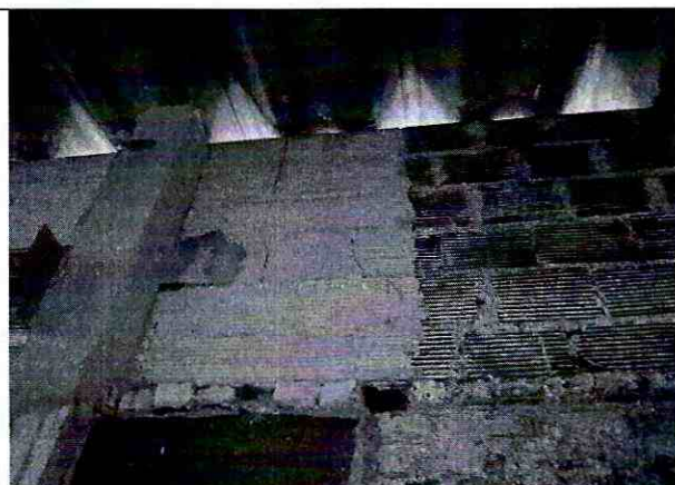
Foto 12. Fisuras y grietas en la parte interna del muro.
