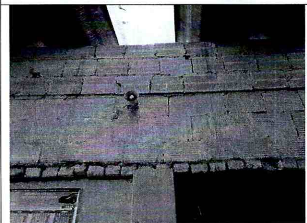
Foto 11. Fisuras que siguen la línea de pega entre bloques.
