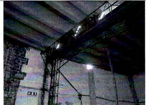
Foto 22. Deterioro incipiente y daño leve de la cubierta.
