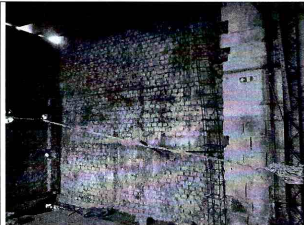
Foto 7. Vértice suroriental, no existe traba entre muros.
