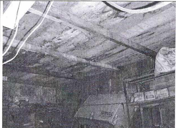
Foto 7. Vista interior primer piso parte posterior. Humedades y eflorescencias bajo placa
