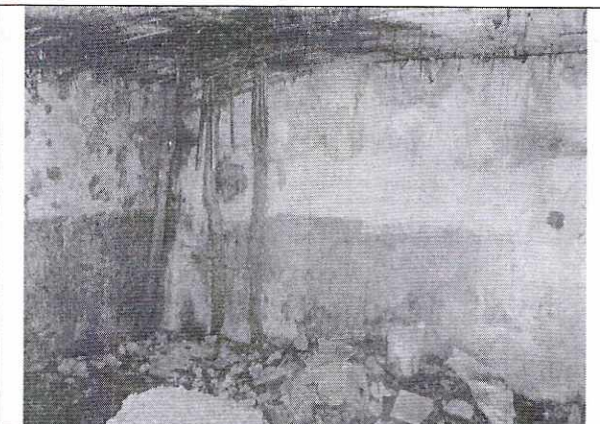
Foto 7. Vista interior segundo piso parte frontal. Humedades y eflorescencias
