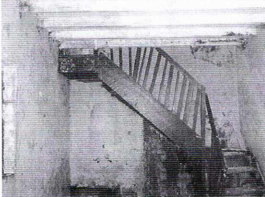
Foto 11. Vista interior primer piso. Escalera de madera en desuso, presenta desprendimiento de elementos
