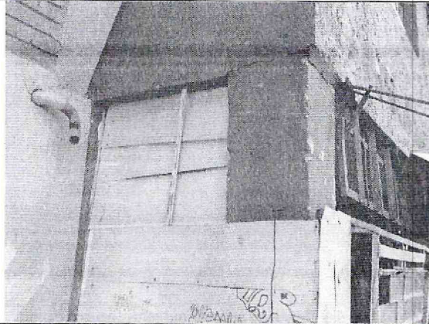
Foto 3. Detalle en fachada costado oriental. Agrietamiento entre placa de entrepiso y machón
