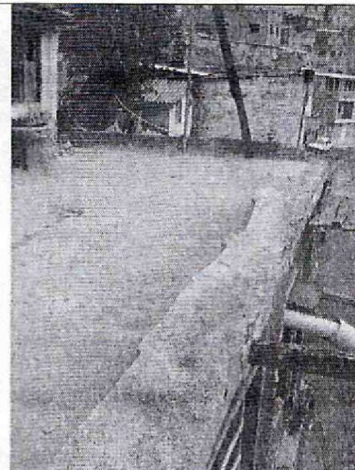
Foto 4. Detalle placa plana cubierta parte frontal. Agrietamiento en elemento sobrepuesto de borde
