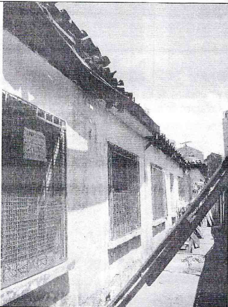
Foto 3. Fachada por la Diagonal 21 A Sur. Pérdida de revoque (pañete) en cielo raso alero cubierta
