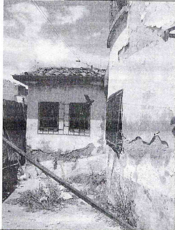
Foto 2. Fachada por la Transversal 21 A. Pérdida de revoque (pañete) en muros y cielo raso alero cubierta, agrietamiento perceptible a simple vista
