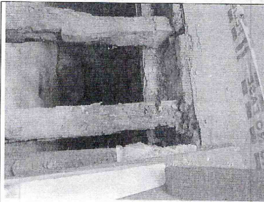
Foto 19. Elementos de entrepiso sin capacidad de soporte.
