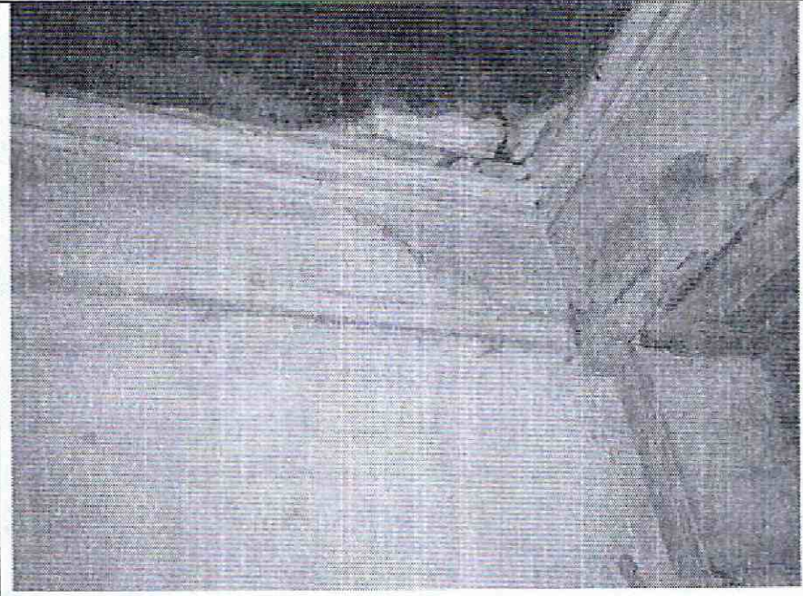
Foto 14. Grieta en parte alta de muro de segundo nivel.
