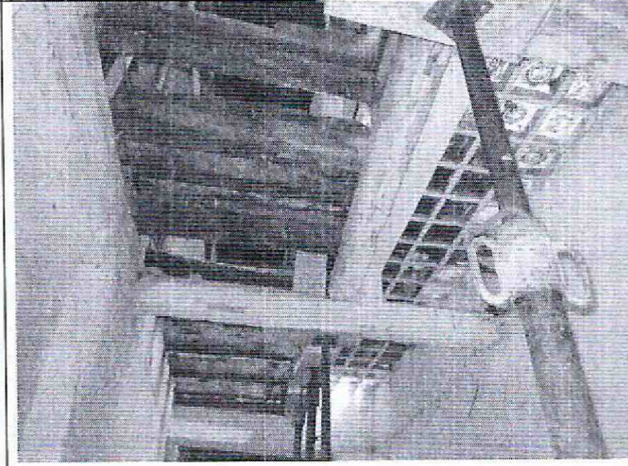
Foto 18. Elementos de entepiso con deterioro alto.
