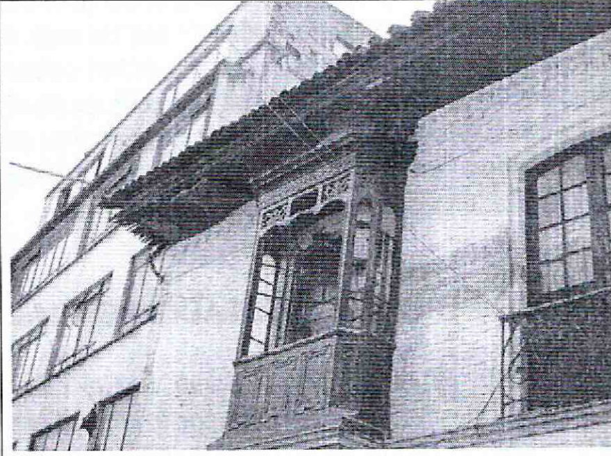
Foto 2. Fachada y daños a nivel de cubierta.
