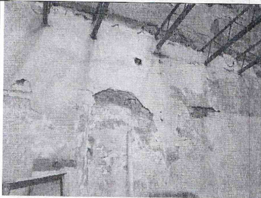
Foto 9. Acabados de muros con deterioro alto.
