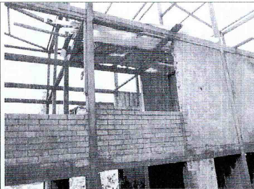
Foto 14. Deterioro generalizado por falta de cubierta.
