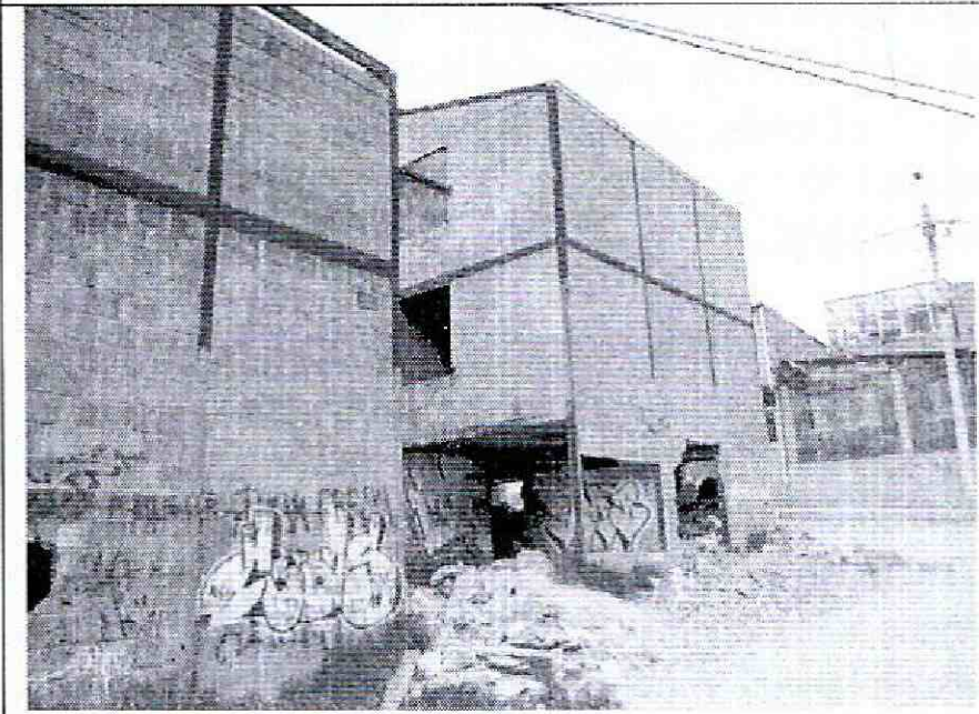
Foto 4. Fachadas externas con deterioro y demoliciones.
