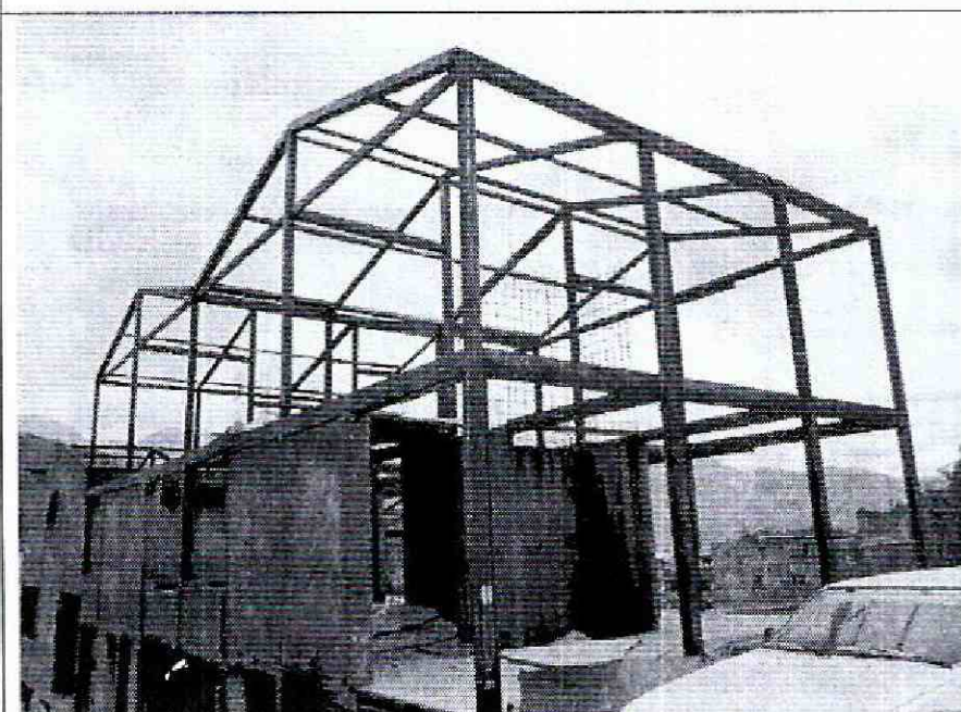
Foto 15. Estructura en proceso de construcción, deterioro.
