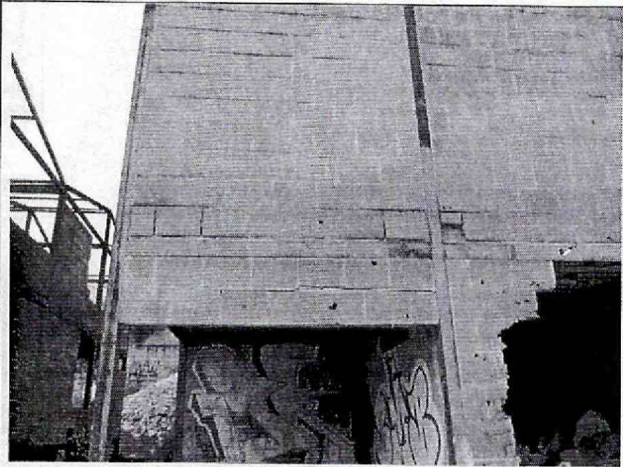
Foto 8. Daño en muro de culata o fachada lateral.
