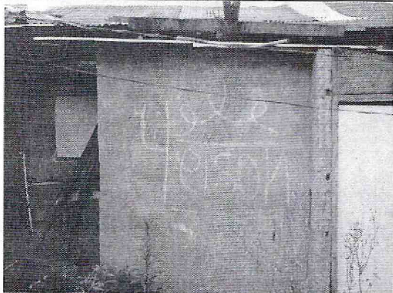
Foto 3. Parte de la fachada interna sector 1. Se observa daño leve (ver foto 4)
