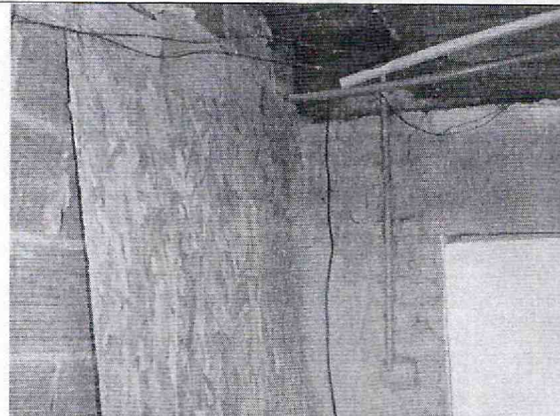
Foto 4. Detalle fachada sector 1. Se identifica características de los materiales del muro (adobe y bloques de arcilla de perforación horizontal). Se observa daño leve.
