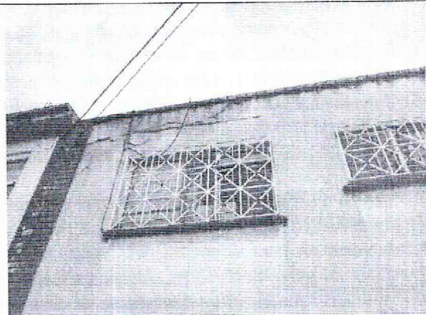
Foto 4. Deterioro de los acabados del muro de fachada.
