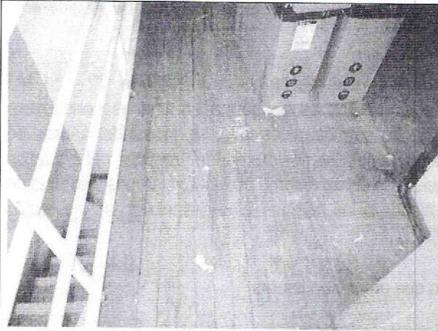
Foto 19. Entrepiso en madera, deterioro moderado.
