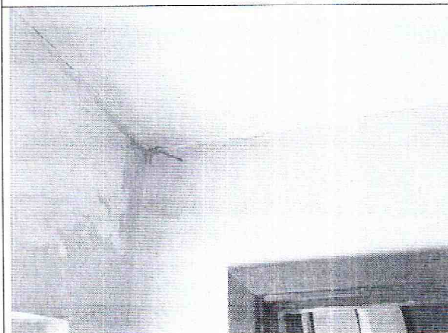
Foto 15. Fisura en dintel de segundo piso.
