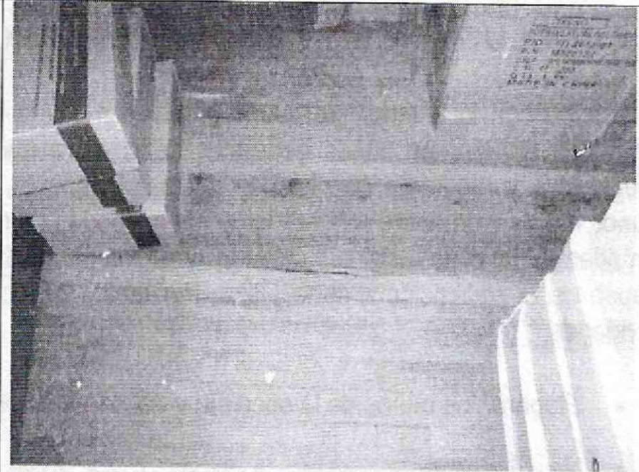
Foto 20. Falta mantenimiento del entrepiso en madera.
