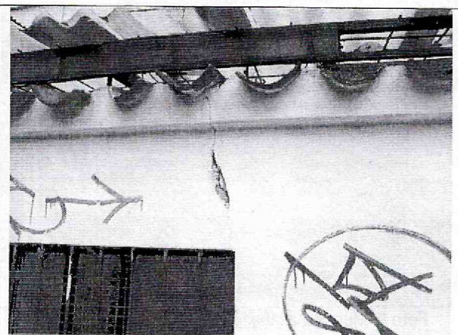
Foto 4. Grieta en muro del costado occidental.
