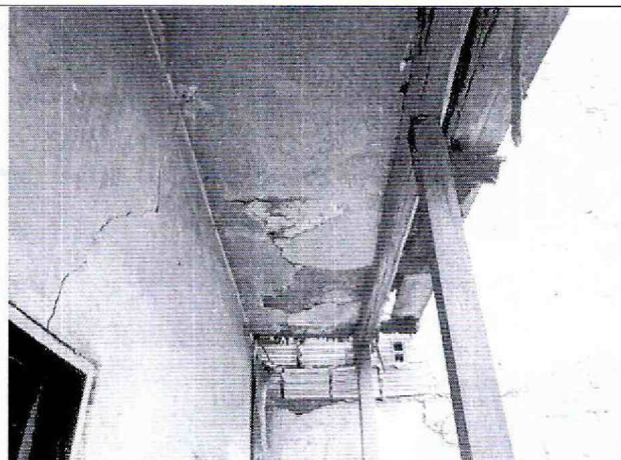
Foto 18. Daño y deterioro fuerte del cielo raso.
