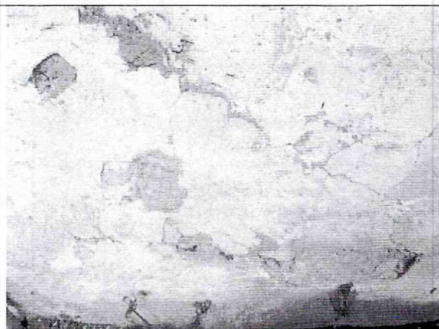
Foto 13. Desprendimiento del pañete de recubrimiento.
