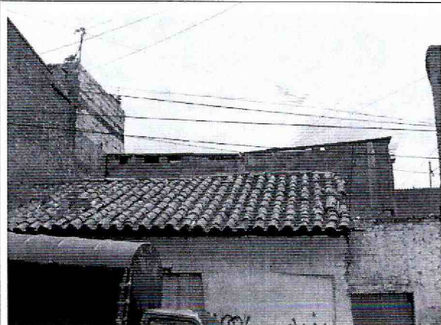
Foto 19. Sector frontal de la cubierta, deformaciones.
