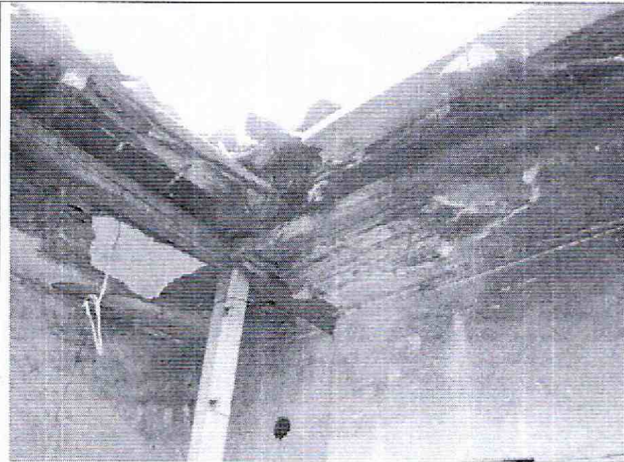
Foto 16. Daño de elementos y deterioro del cielo raso.
