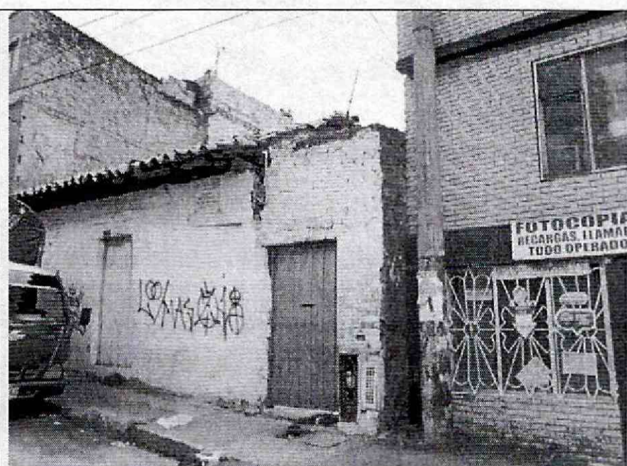
Foto 2. Fachada con deterioro moderado de los acabados.
