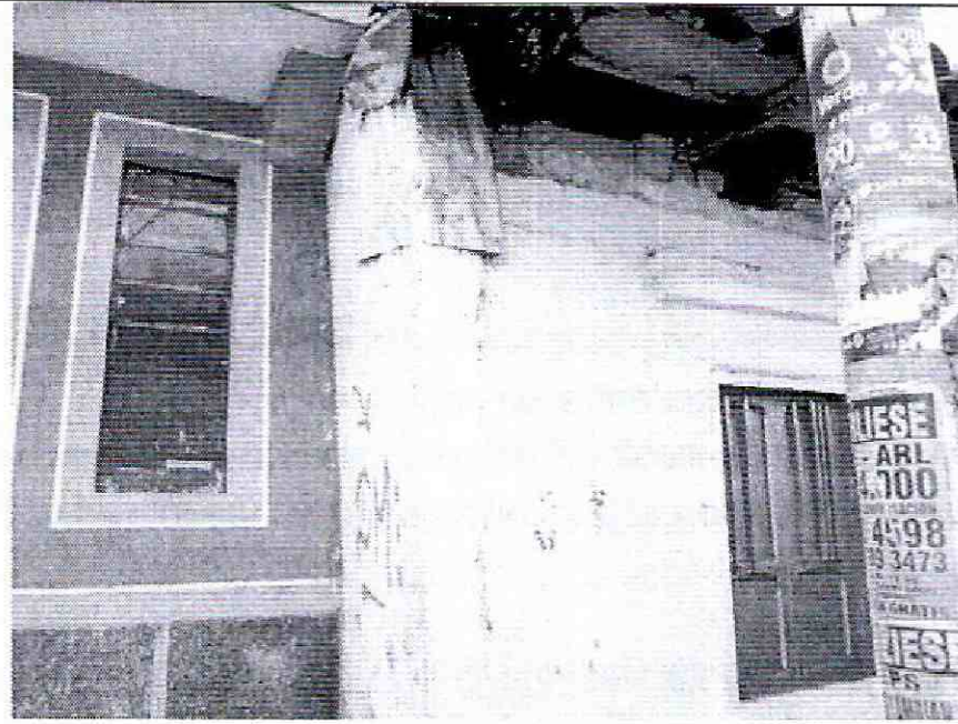
Foto 3. Agrietamiento en el extremo norte de la fachada.
