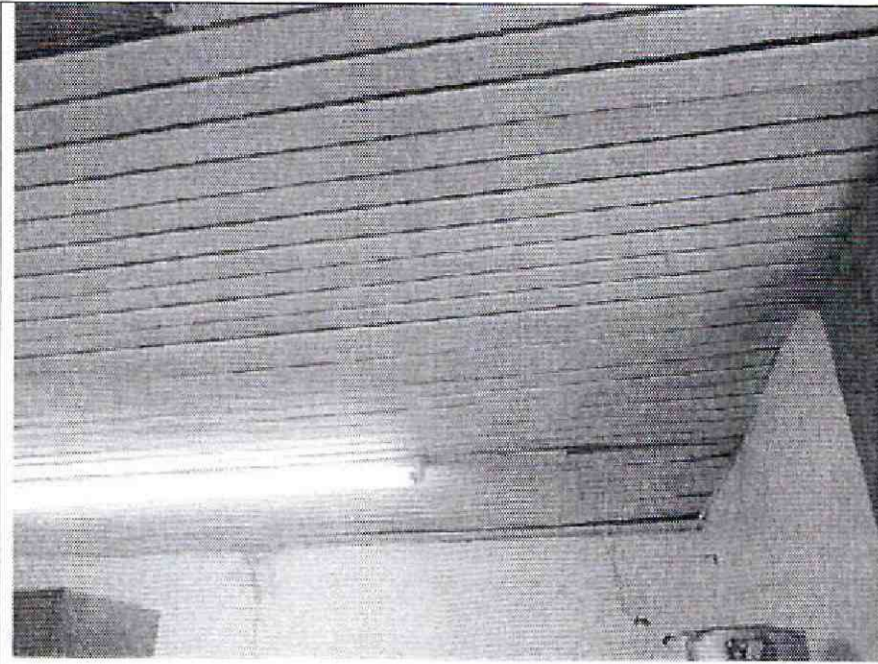
Foto 31. Deterioro moderado de cielo raso.
