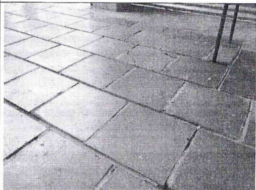
Foto 34. Daño del piso por hundimientos
