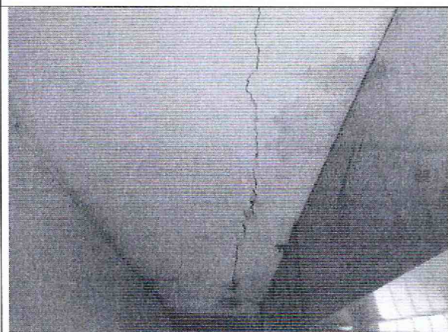
Foto 18. Daño severo en placa de segundo piso.
