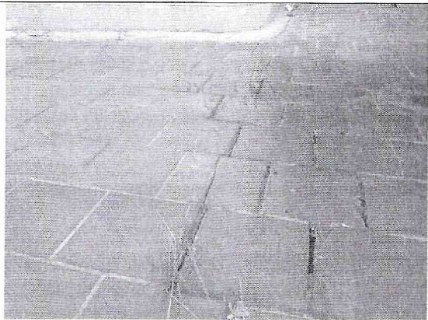
Foto 33. Agrietamientos en el piso
