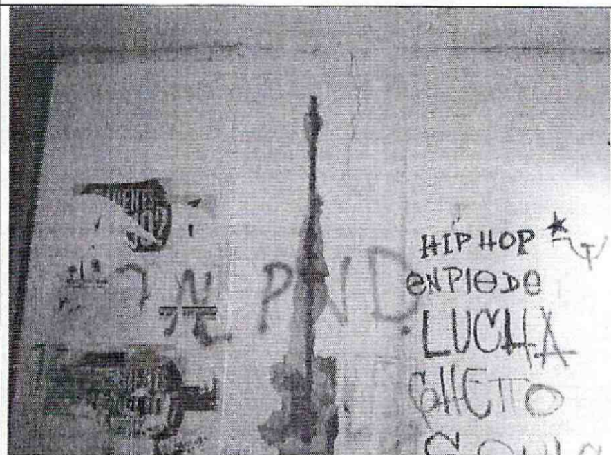
Foto 22. Grietas en muros de primer piso, daño fuerte.
