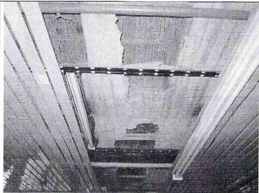
Foto 21. Zona sin torta inferior, con cielo raso.
