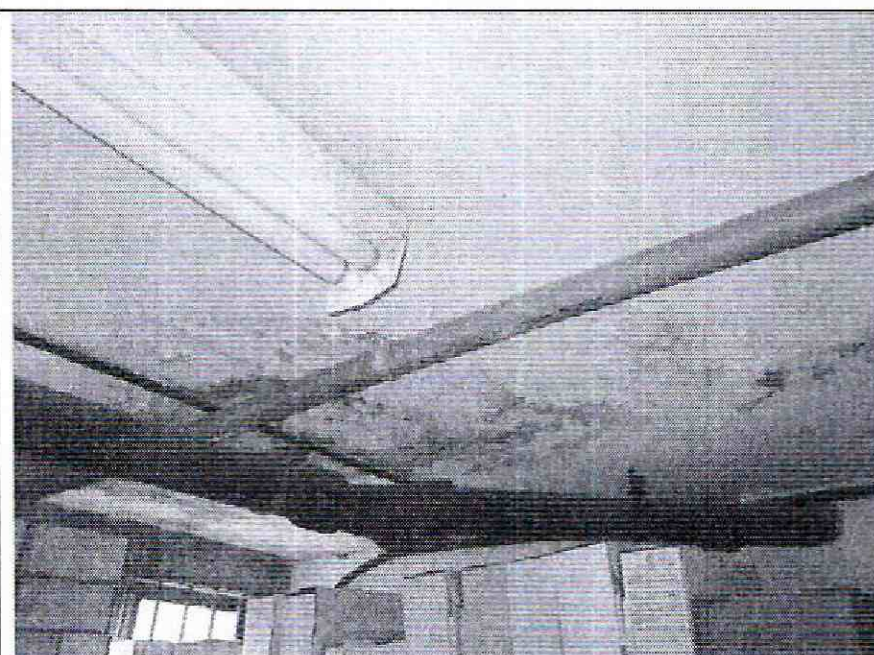
Foto 29. Daño de los acabados de placa de entrepiso.
