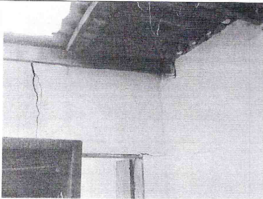
Foto 17. Fractura de muro en segundo piso.
