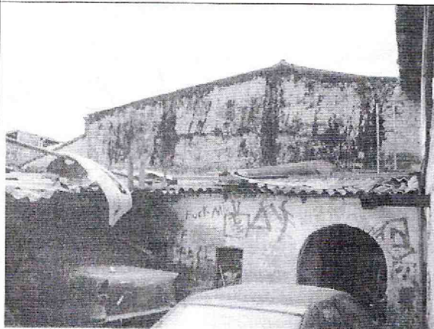
Foto 31. Aspecto de la cubierta del sector norte, deterioro.
