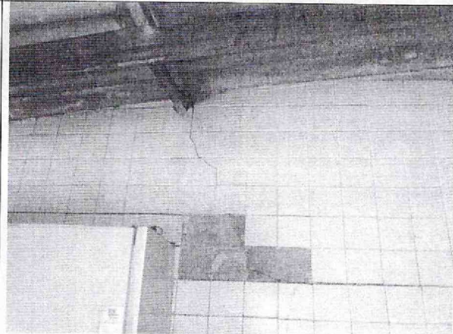
Foto 18. Daño severo en muros internos de segundo piso.
