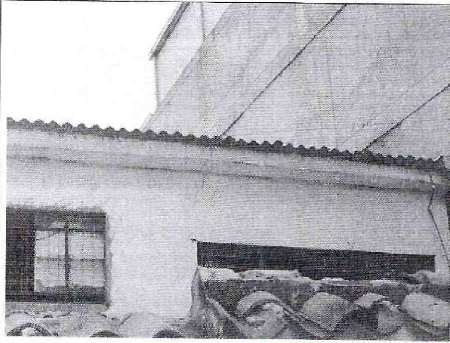
Foto 3. Agrietamiento en muro de fachada.
