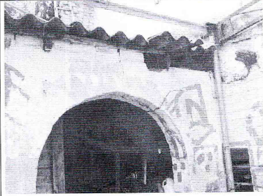
Foto 10. Daño estructural de muro, fractura.
