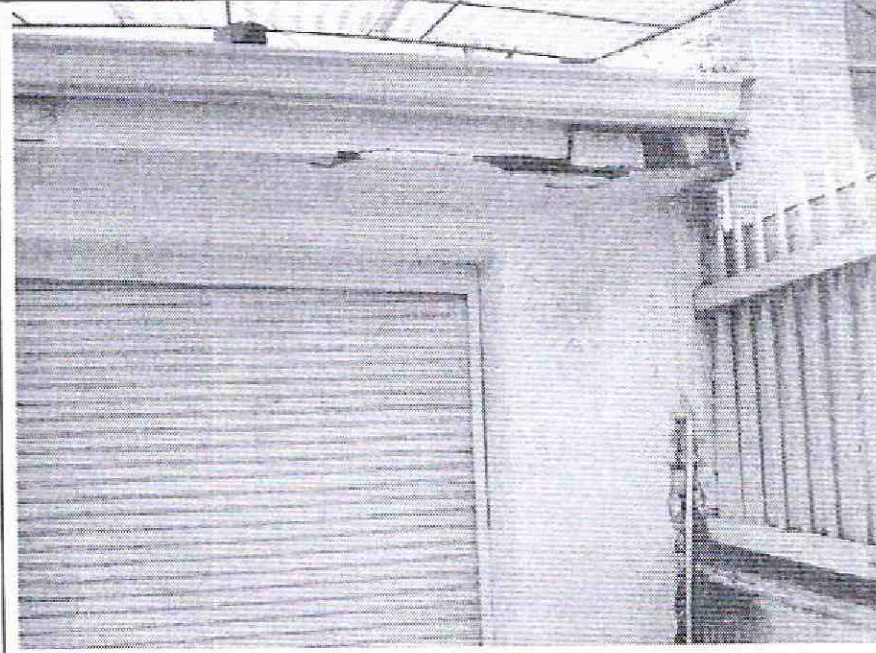
Foto 12. Deformación de vanos de puertas, sector sur.
