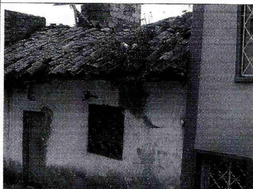
Foto 10. Colapso parcial de la cubierta.
