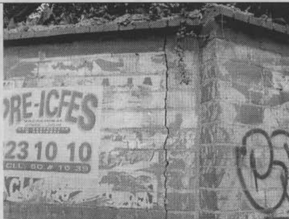
Foto 3. Grietas en el muro.
