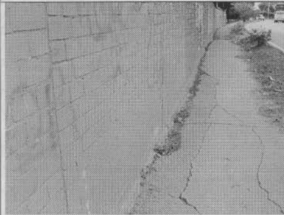
Foto 9. Pérdida de verticalidad en algunos tramos.
