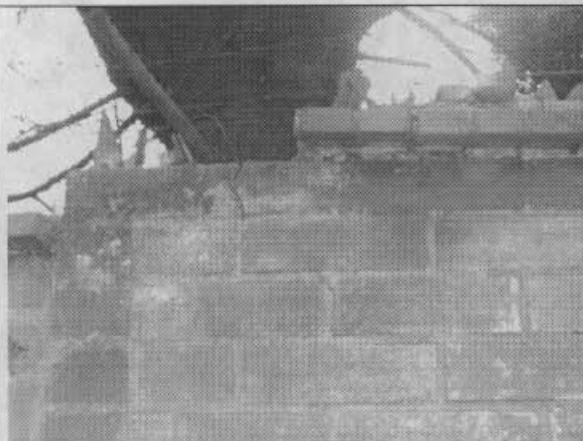
Foto 5. Grietas y pérdida de piezas de mampostería.
