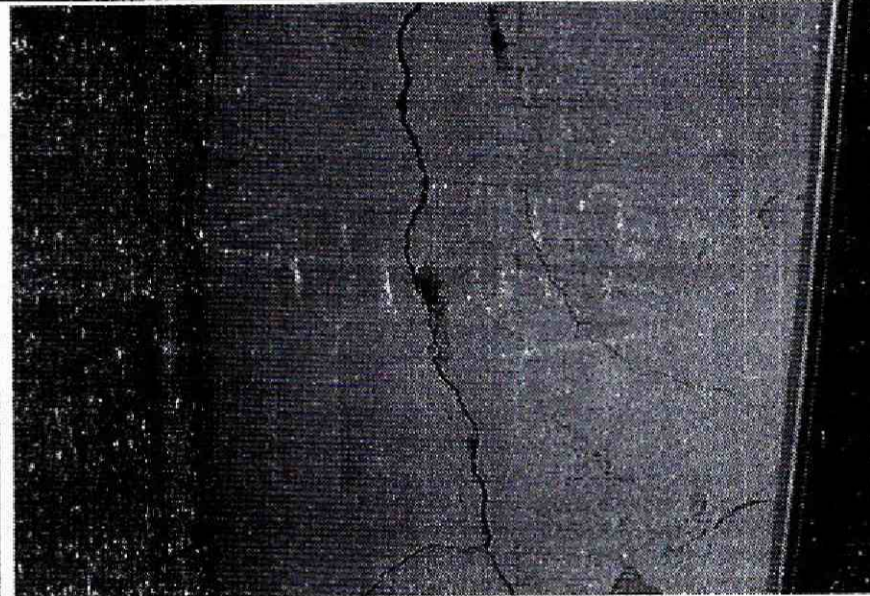
Foto 4. Agrietamiento en la cara interna del muro de fachada.
