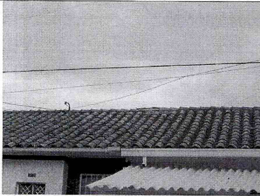
Foto 7. Deformaciones leves y daños en cumbrera.
