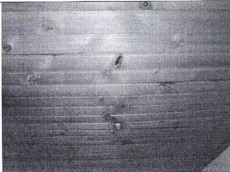
Foto 15. Leves deformaciones del cielo raso por humedad.
