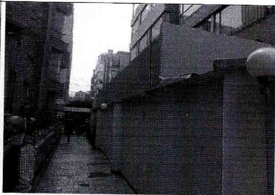
Foto 10. Pérdida de verticalidad de la parte superior del muro.
