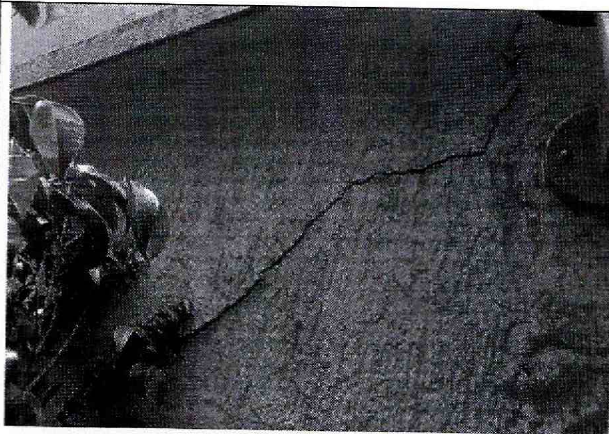
Foto 7. Agrietamiento en la parte superior del muro.
