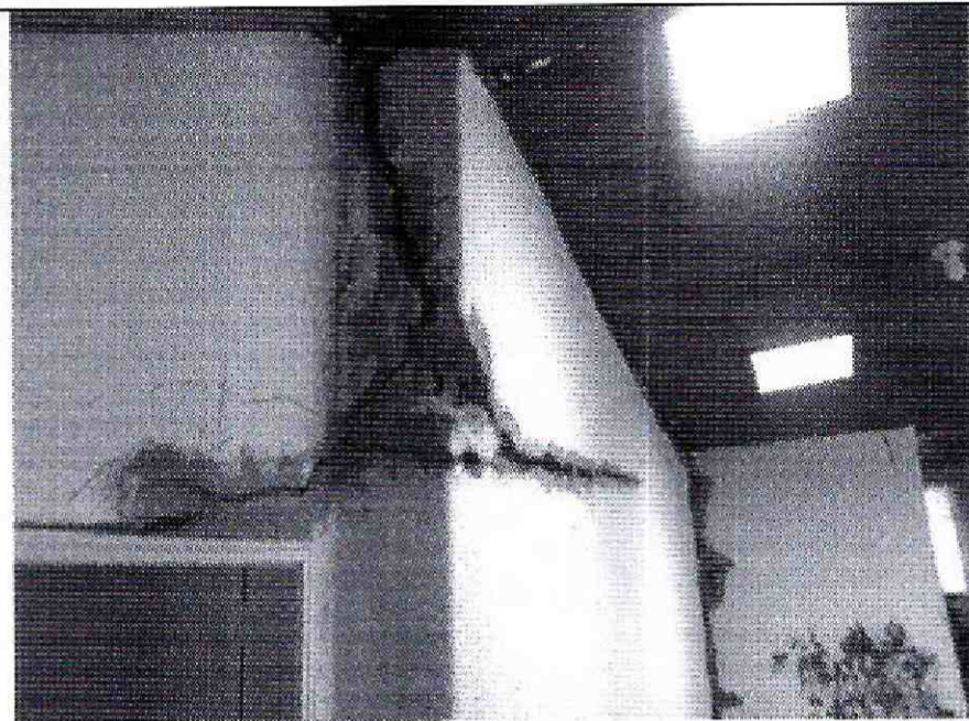
Foto 5. Muros internos en malas condiciones.
