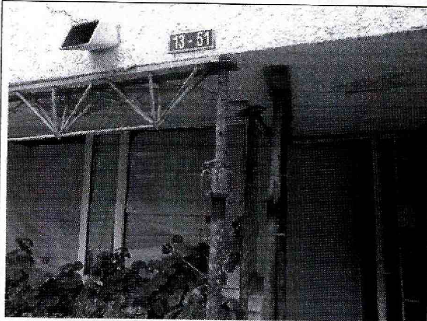
Foto 3. Fractura en muro de fachada, apuntalamiento provisional.
