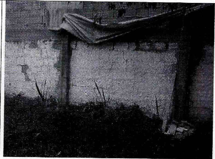
Foto 14. Daño en los muros de cerramiento de la parte posterior del inmueble.
