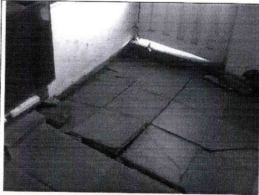
Foto 11. Daños en la placa de piso de la edificación.
