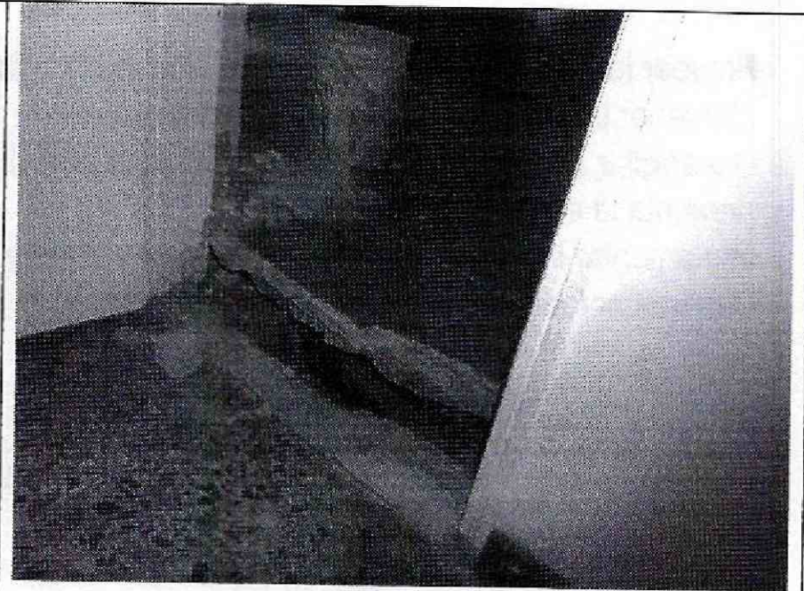
Foto 12. Fractura en la placa de piso.
