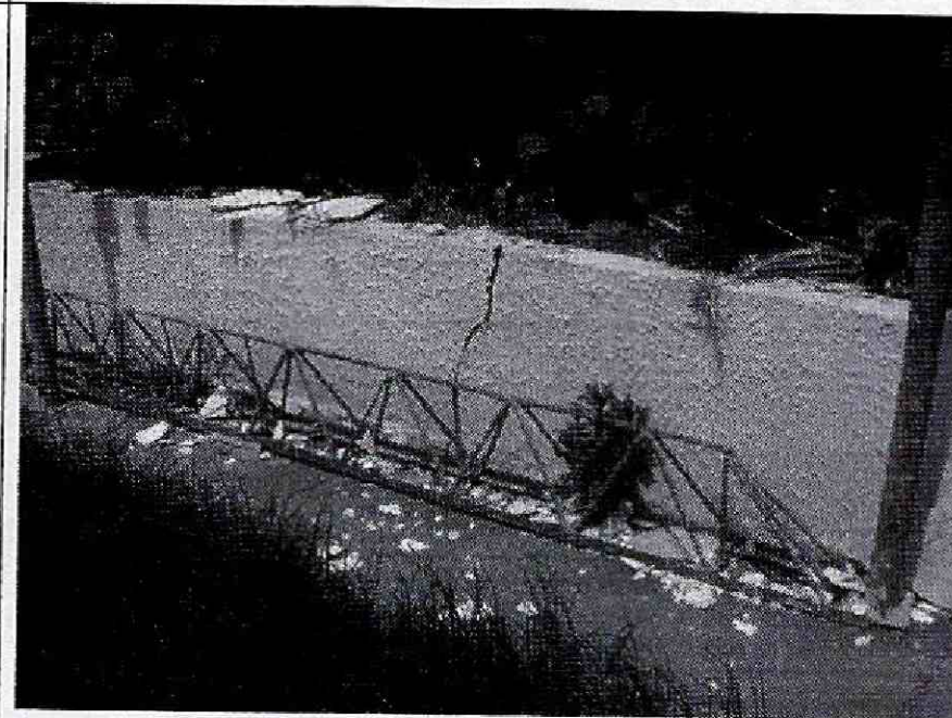
Foto 4. Fractura en la base del muro de la jardinera de fachada.
