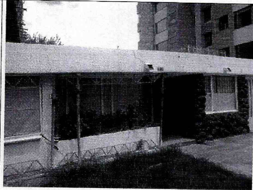
Foto 2. Daños en los elementos que conforma la fachada.
