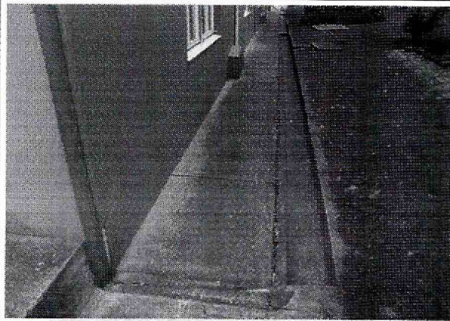
Foto 5. Afectación en zonas exteriores del costado norte.
