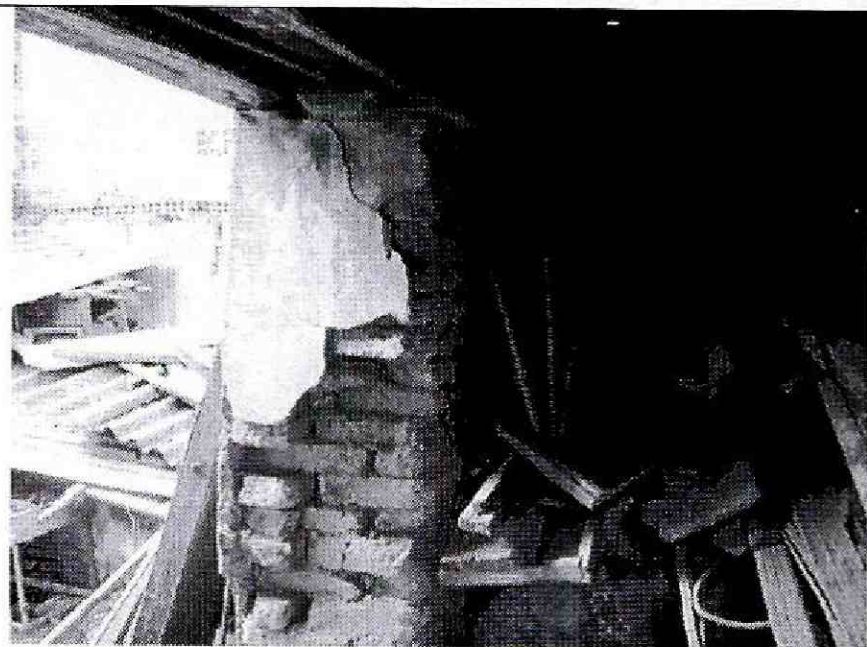
Foto 19. Alto deterioro en muro del sector posterior.
