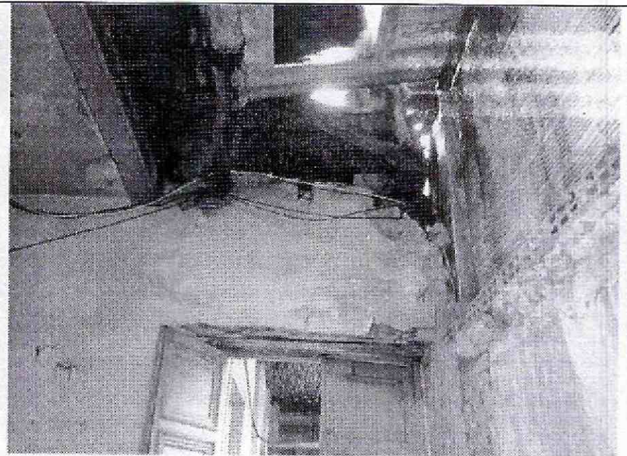
Foto 20. Daños en dintel y otros elementos.
