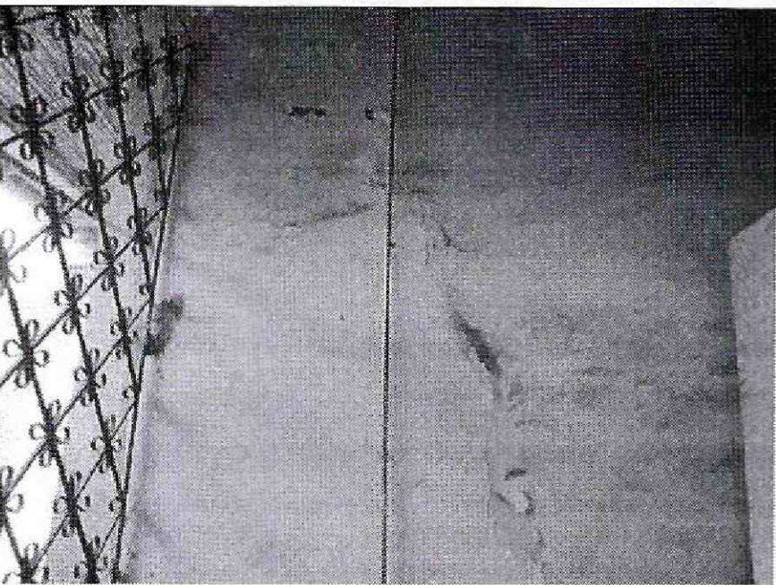
Foto 11. Fisuras en muro del sector posterior.
