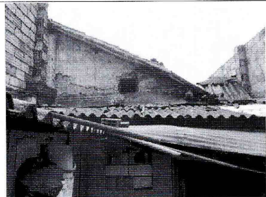
Foto 29. Condiciones de la cubierta en fibro-cemento.
