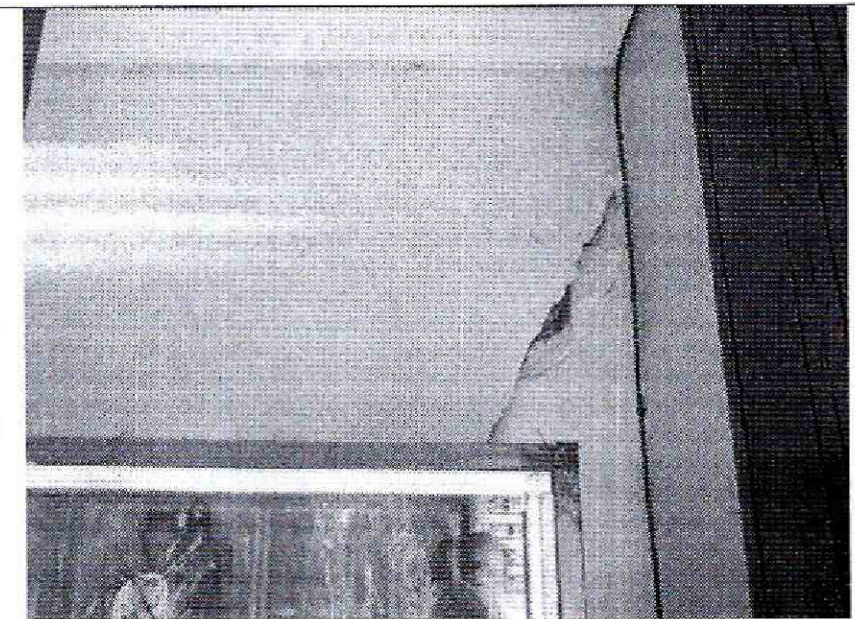
Foto 5. Grieta en muro del costado sur.
