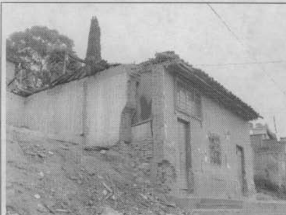
Foto 5. Muro del sector sur sin apoyos laterales.
