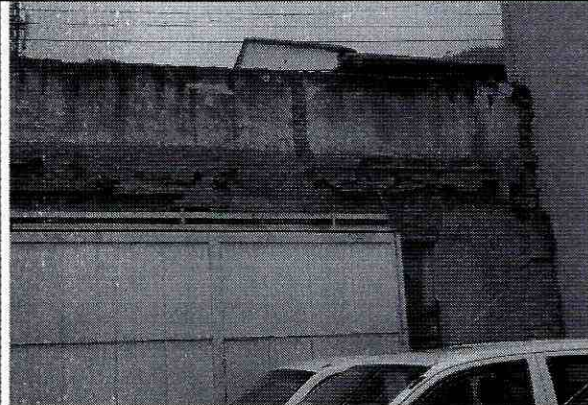
Foto 4. Desprendimiento de pañete de acabado de la parte superior del muro de cerramiento.
