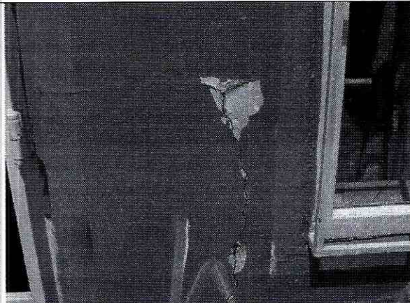
Foto 3 Agrietamiento en el costado norte del muros de fachada.
