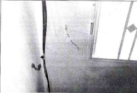
Foto 7. Agrietamientos en muros del costado norte, segundo piso.
