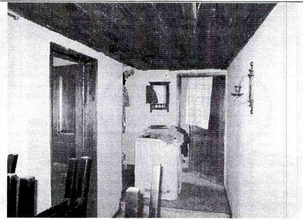
Foto 6. Muros internos sin daños visibles.
