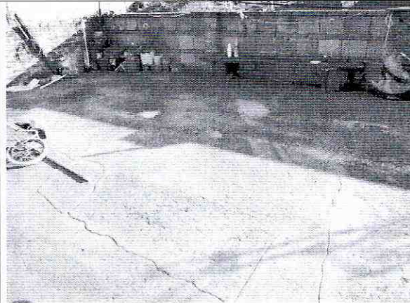
Foto 14. Placa de cubierta, agrietamiento del afinado.
