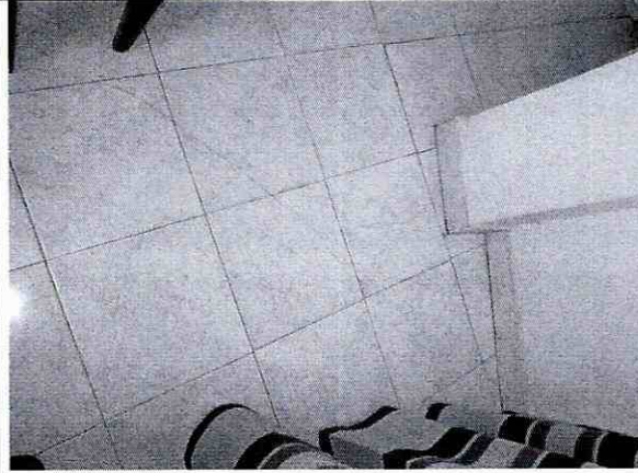
Foto 16. Fisuras en acabados de piso de segundo nivel.
