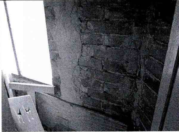
Foto 13. Fisura en fachada de tercer nivel, vista interna.
