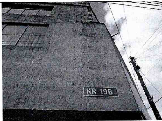
Foto 3. Fisuras en el muro de fachada, sector central.
