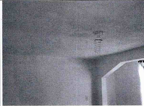
Foto 18. Humedad en cara inferior de placa de cubierta.
