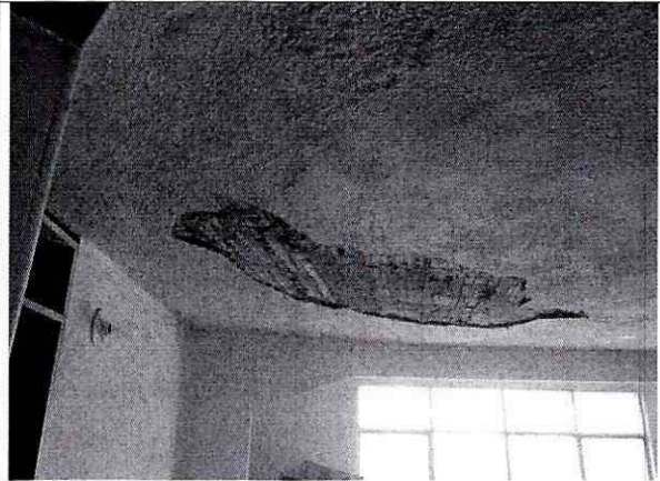
Foto 22. Caída del pañete de recubrimiento de la cubierta.
