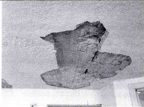
Foto 21. Evidente corrosión del refuerzo de la cubierta.
