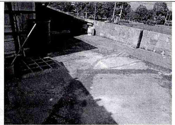
Foto 24. Intentos de reparación de fisuras y grietas.
