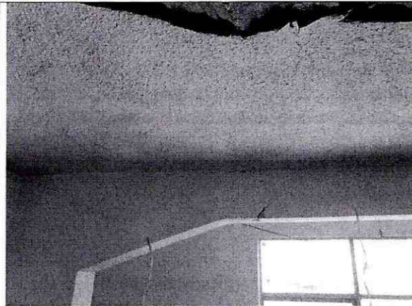
Foto 19. Daño en dintel bajo cubierta.
