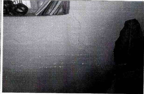
Foto 8. Grietas en muros del primer piso.
