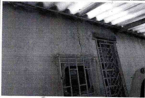
Foto 5. Agrietamientos en muro de cerramiento del costado sur.
