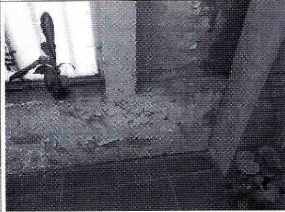
Foto 4. Daños en muro de cerramiento del costado occidental.
