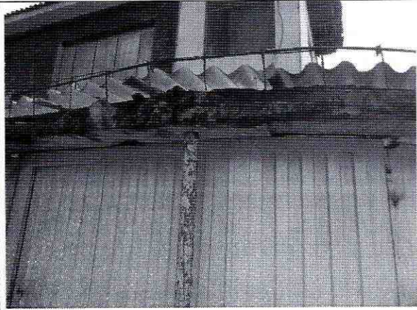
Foto 2. Viga perimetral sobre puerta de acceso en mal estado.
