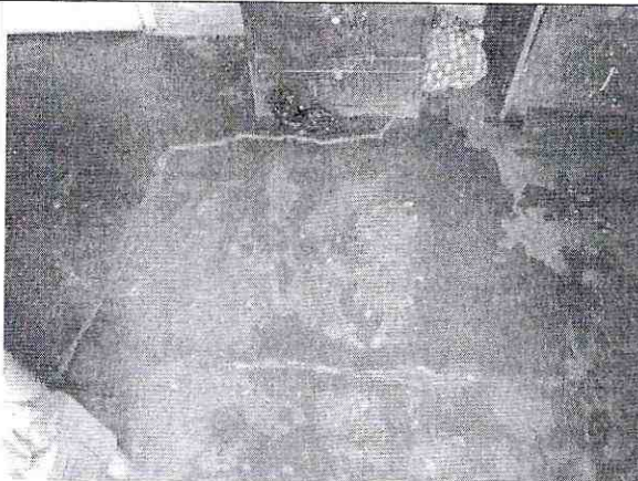
Foto 11. Grietas en la placa de piso del sector posterior.
