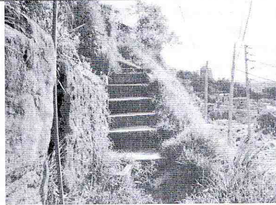
Foto 2. Escaleras de acceso al predio, con deterioro.
