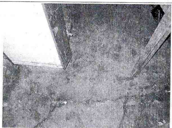
Foto 12. Agrietamientos en el piso del sector posterior.
