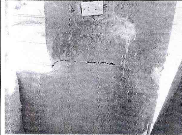
Foto 7. Agrietamiento en muro del sector frontal.
