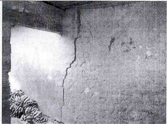
Foto 8. Fractura vertical al centro del muro, costado norte.
