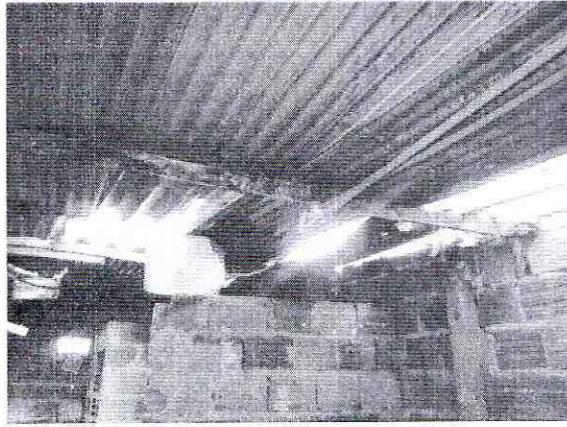
Foto 13. Deterioro de los elementos de la cubierta.
