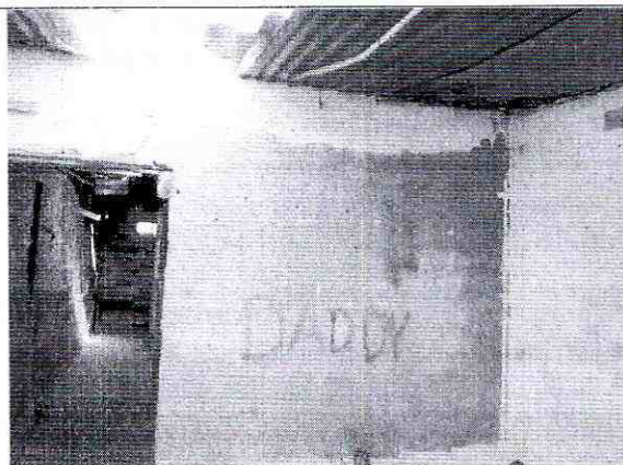
Foto 5. Muros internos con daño de los acabados.
