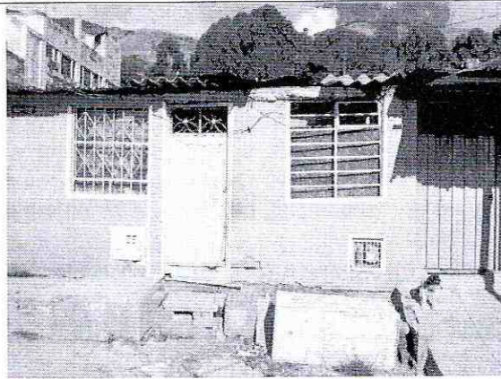
Foto 2. Daños en el muro de fachada del sector sur.
