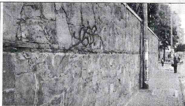
Foto 2. Extremo sur del muro. Se detecta leve pérdida de verticalidad, al igual que en otros tramos.
