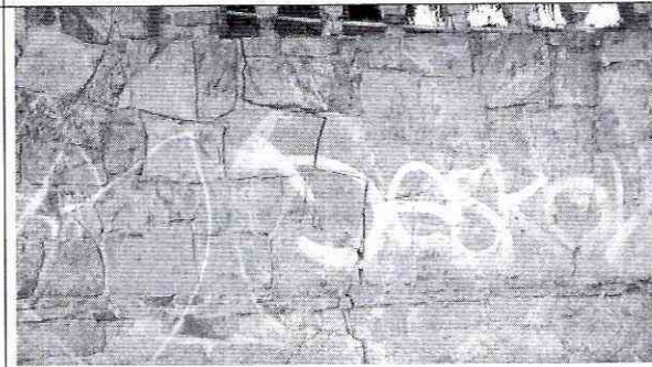
Foto 6. Agrietamiento escalonado, sigue la línea de pega.
