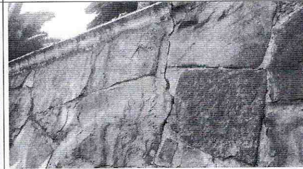
Foto 8. Fisuras y agrietamientos incipientes.
