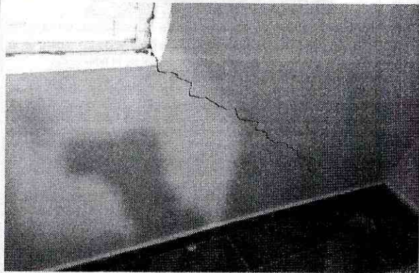
Foto 10. Estado actual de los muros interiores en el segundo piso de la edificación. Se observan fisuras de tendencia diagonal.
