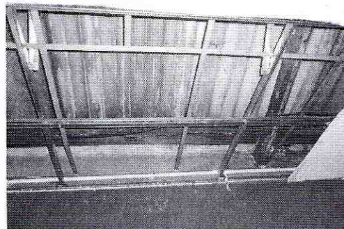
Foto 16. Estado actual de la cubierta en el primer piso. Se observa la falta de un panel de drywall, a pesar de esto las cerchas metálicas se observan en buen estado.
