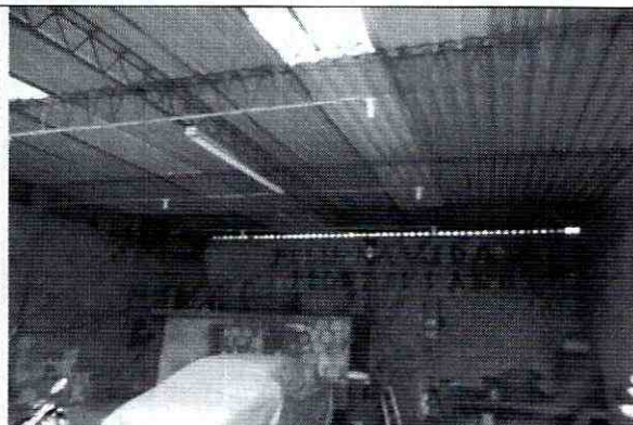
Foto 6. Elementos metálicos del cobertizo en buen estado.
