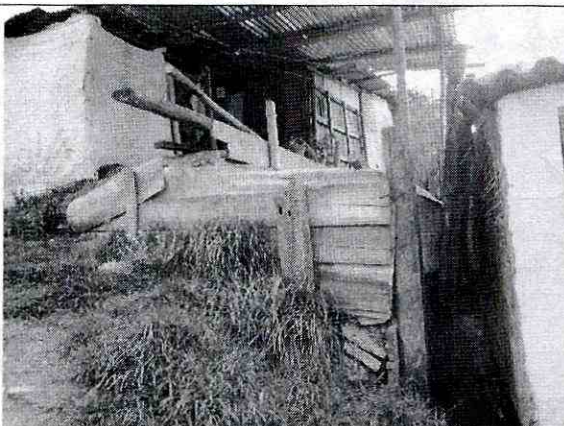
Foto 11. Relleno y elementos de contención vecino.
