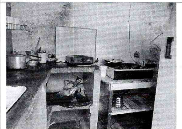
Foto 5. Humedad en muro del sector de la cocina.
