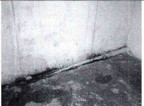
Foto 4. Humedad en la base del muro.
