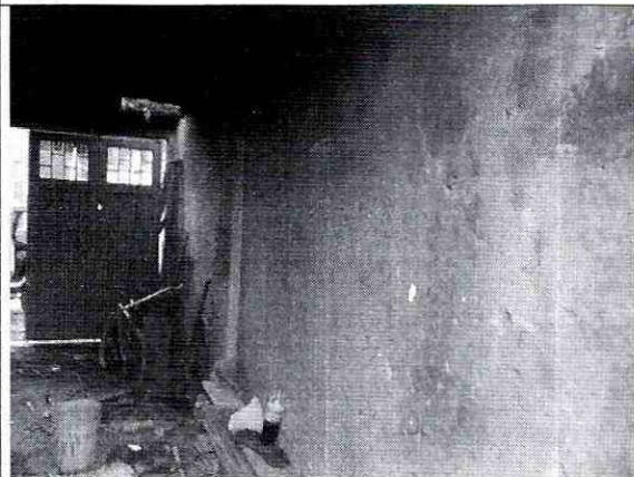
Foto 4. Muros de la zona frontal en buen estado.
