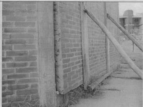
Foto 4. Separación de los muros de la estructura .
