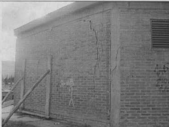
Foto 3. Estado externo de los muros perimetrales.
