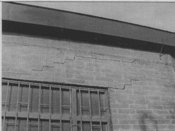
Foto 5. Fractura de muros perimetrales.
