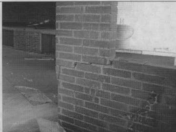
Foto 7. Fractura de muros internos.
