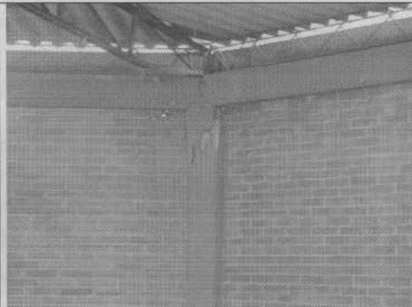
Foto 8. Fractura de elemento estructural principal.
