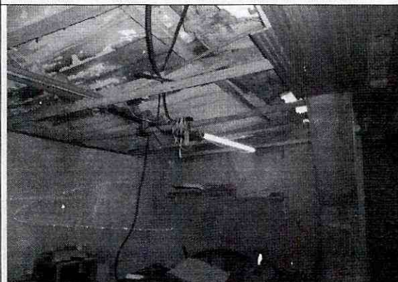
Foto 12. Deterioro en los elementos de madera del cielo raso del local ubicado en la nomenclatura No. 9 - 57
