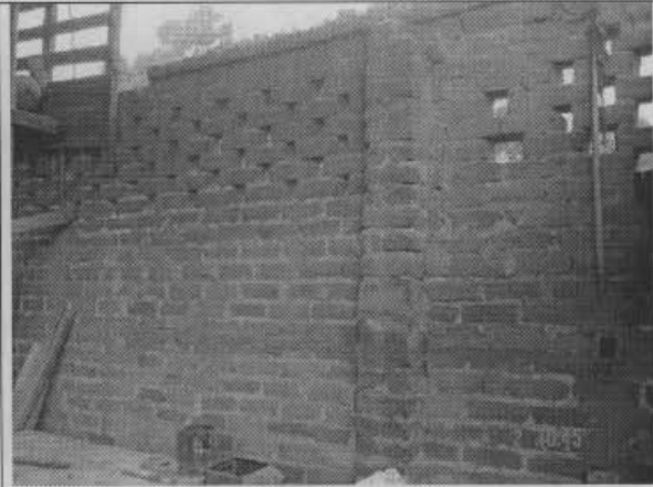
Foto 12. Pérdida de verticalidad puntual del muro de cerramiento.
