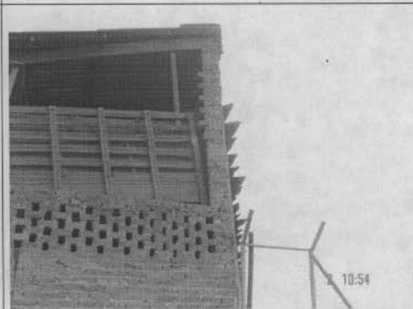
Foto 14. Pérdida de verticalidad de la culata occidental.
