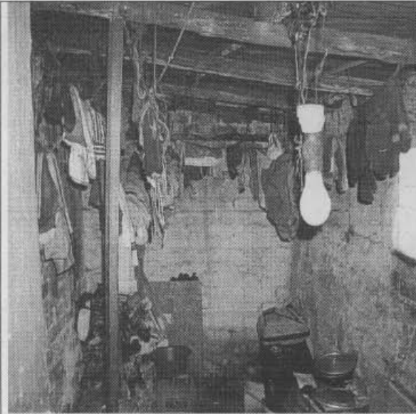
Foto 5. Deterioro progresivo del inmueble.
