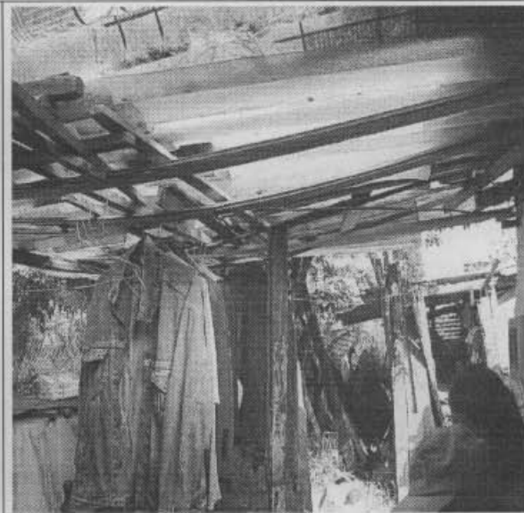
Foto 6. Entramado de madera en el sector de cubierta con deficientes condiciones estructurales.
